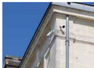
Sécurité : Installation d'un réseau de caméras de vidéo-protection.
